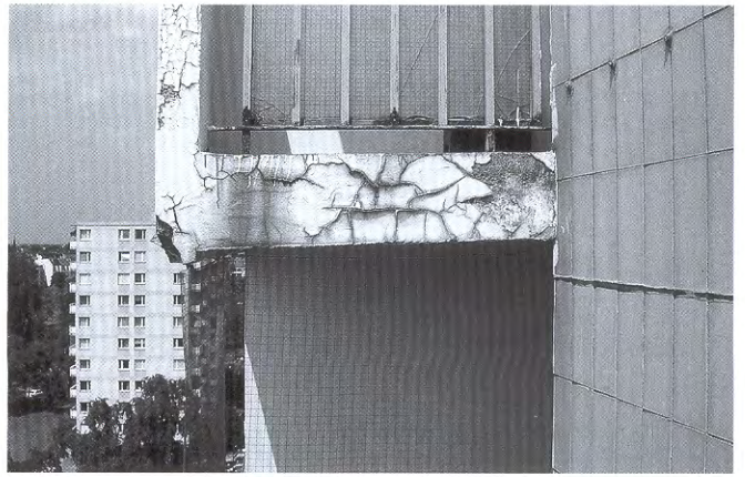
221 Repräsentatives Schadensbild an der Betonkonstruktion der Balkon-Loggien, 2006
